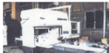
レーザー切断機の防振
