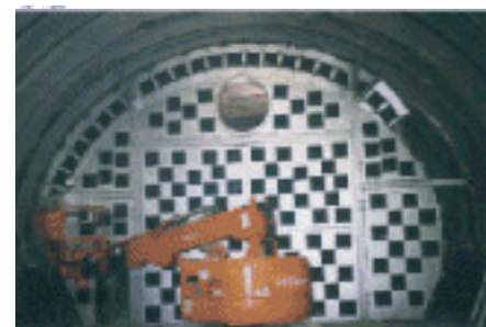
トンネルの低周波用防音扉
